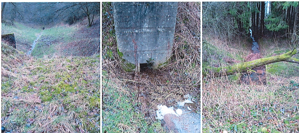
Fotos (von links): Blick von Dammscharte zum Becken und Autobahndamm, Mönchbauwerk mit Einlauföffnung 40x40 cm, Blick auf Auslauf und Tosbecken
