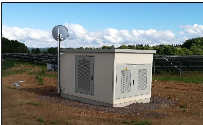
Abb. 2. Beispiel für eine Trafostation (Foto: BGHplan Juni 2017)
