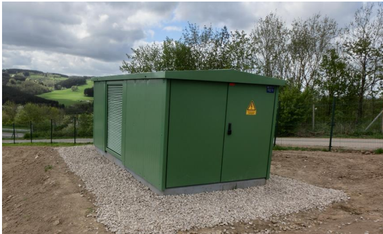
Abb. 3 Beispiel für eine Trafostation (Nebenanlage); Foto BGHplan 2018
